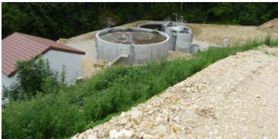
Station d'épuration de Nurieux-Volognat
