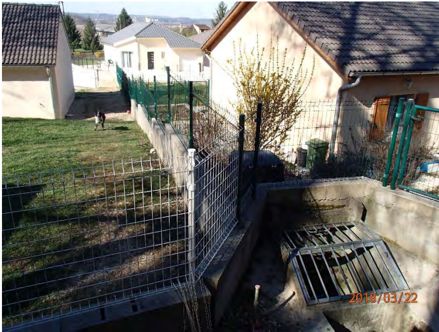
Figure 46 : Grille avaloir sous dimensionnée
