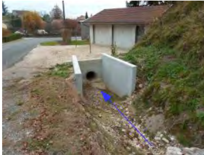
Figure 50 : Ouvrage sous dimensionné au niveau du hameau des Granges (source : CEREMA)
