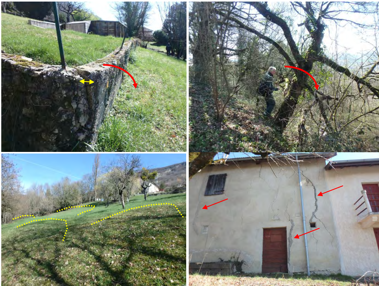
Figure 10 : Divers désordres constatés sur ce secteur
