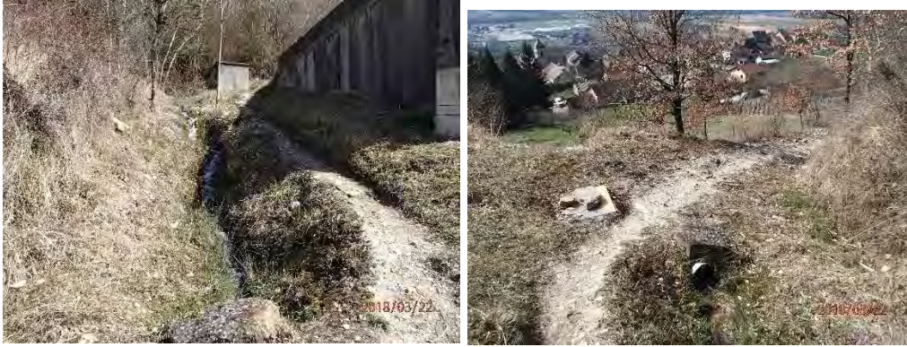
Figure 29 : Axe de ruissellement issu d'un réservoir et buse sous dimensionnée en cas de ruissellement
