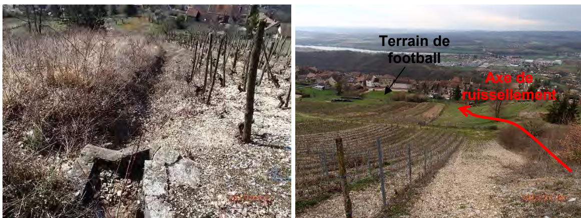
Figure 37 : Exemple d'érosion de ravine en amont de Montagnieu et direction suivie par les ravines
