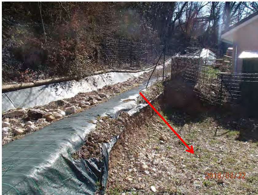
Figure 45 : Point de débordement possible au niveau de la déviation Nord
