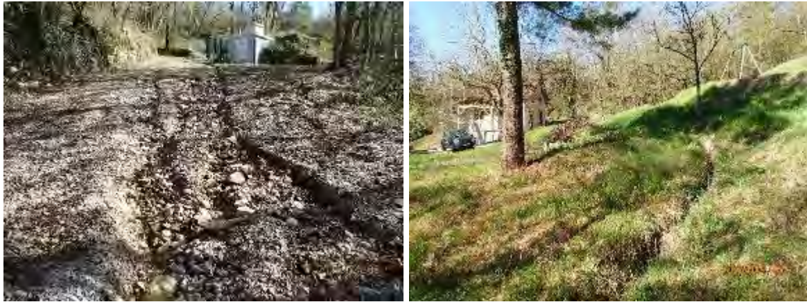
Figure 48 : Piste ravinée (à gauche) – terrasses et cunettes redirigeant les eaux vers l'Est, évitant ainsi la maison au second plan
