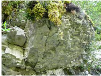
Figure 5 : exemple de masse de 0,5\text{m}^3 en surplomb
