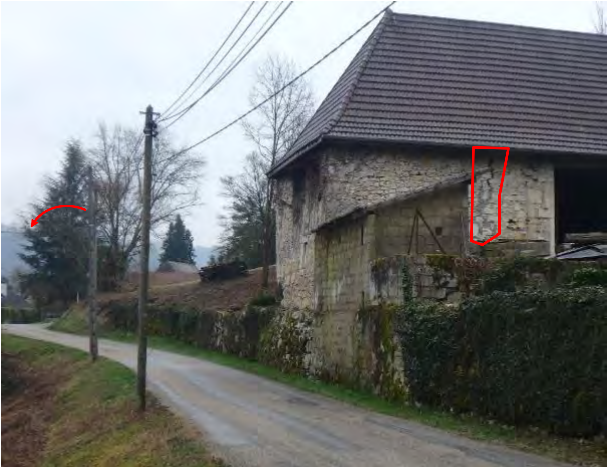
Figure 23: Exemple de désordres dus à des terrains de mauvaise qualité
