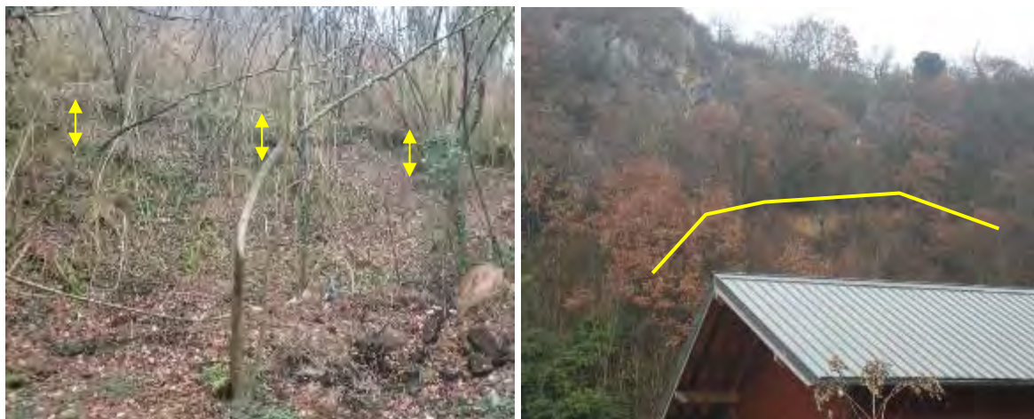
Figure 22 : Exemples permettant de constater une couche sensible aux glissements sur les éboulis (à droite entre le chef-lieu et la Bruyère, à droite : La Bruyère)
