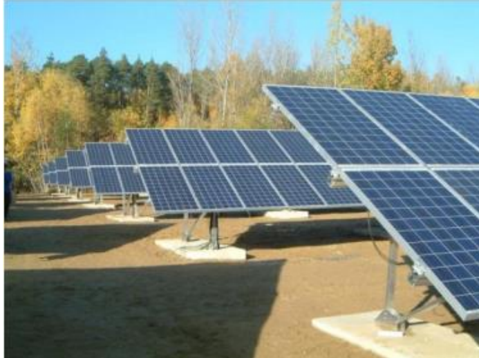
Figure 10: Exemple de parc photovoltaïque utilisant des longrines en béton
