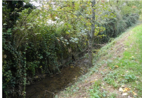
Berge rive gauche érodée, laissant apparaître un ancien mur
