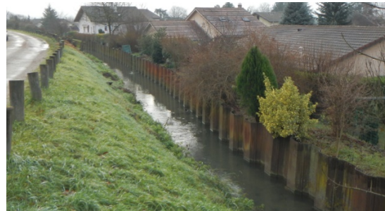
Berge protégée par des palplanches ou murs
