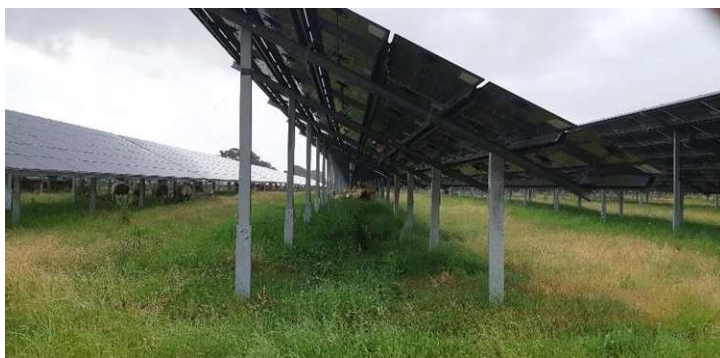
Exemple de végétation sous panneaux et en inter-rang (source JPEE, Braize ; juin 2020)
