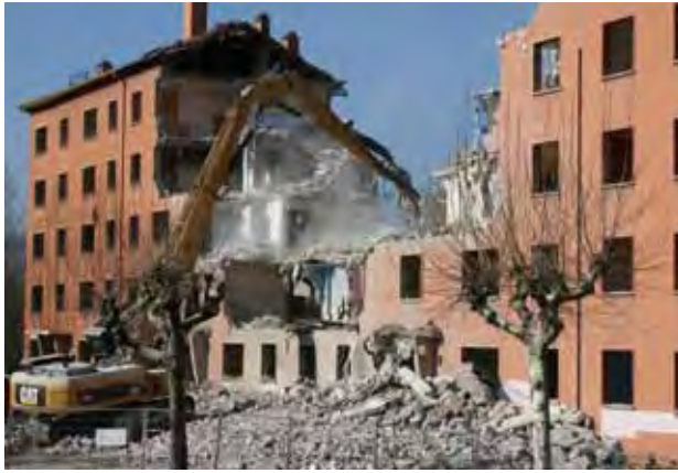
Bellegarde Beauséjour : démolition en mars 2011 de 100 logements pour le renouvellement urbain du quartier
