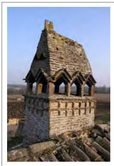
Ferme du Mont à Chevroux, monument historique classé en 1925, restauration de la cheminée dite "sarrasine", élément construit vers la fin du XVIème siècle
