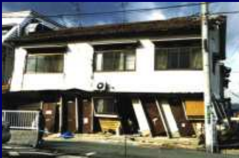
Séisme de Kobé Japon 1995
