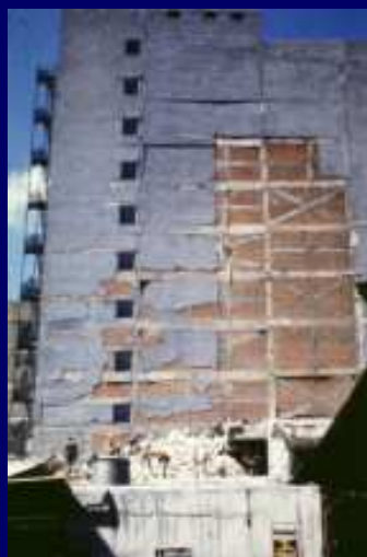
Mexico (après le séisme de 1985)
