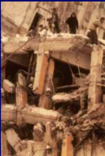
Rupture fragile (instantanée) séisme de Spitak, Arménie 1988
