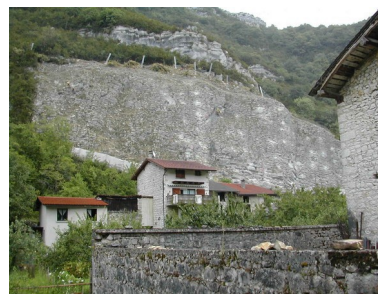
Filets de protection - Cerdon
