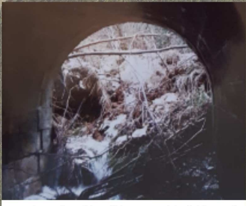
2 Amoncellement de matériaux en amont du rétablissement sous la voie ferrée (combe est) en février 1990 (photographies de M et Mme Laplace)
