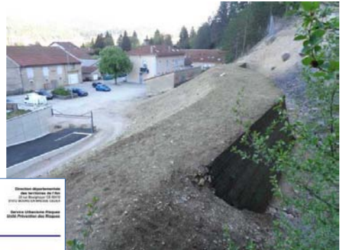
Merlon et filets de protection à Montréal la Cluse
