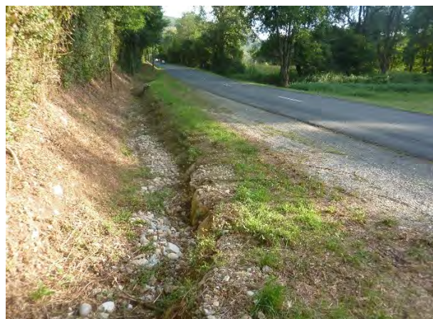
Fossé exutoire de la combe le long de la RD31j (avec présence de matériaux grossiers (n°4))
