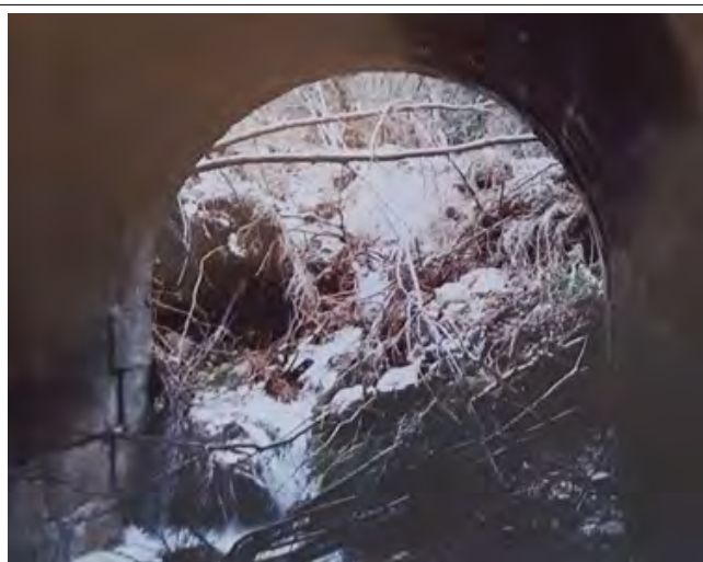
Amoncellement de branches et terres en amont du rétablissement sous la voie ferrée (combe est) en février 1990 (n°2) (photographies de M et Mme Laplace)
