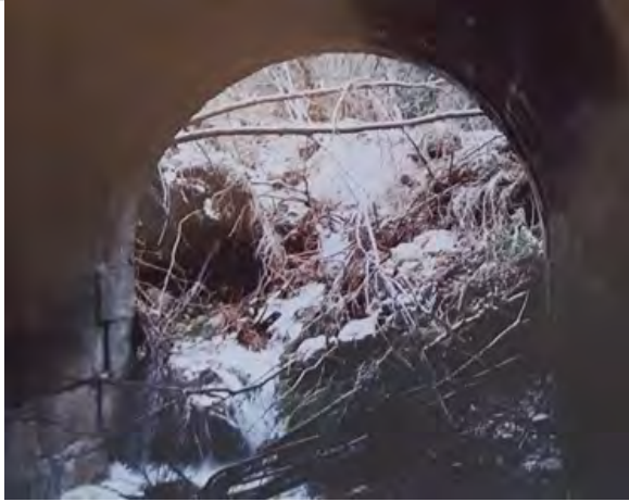
Amoncellement de branches et terres en amont du rétablissement sous la voie ferrée (combe est) en février 1990 (n°2) (photographies de M et Mme Laplace)
