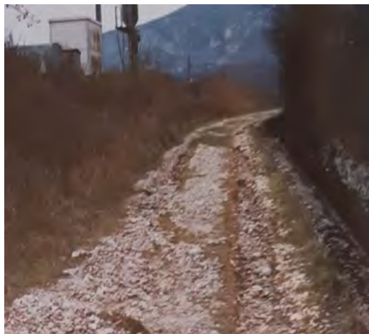
Chemin de Cratier (fossé), après les inondations de 1990 (n°9)
