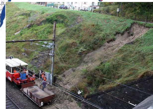
Etude IMS-RN 2016 - Fig. 38 : Arches de confortement maçonnées (en haut à gauche de la photographie) le long de la voie ferrée Genève-Paris, à Coupy. A noter que le glissement du 07 au 08 novembre 2014 s'est produit là où le talus n'est pas conforté [Source : www.ledauphine.com]
