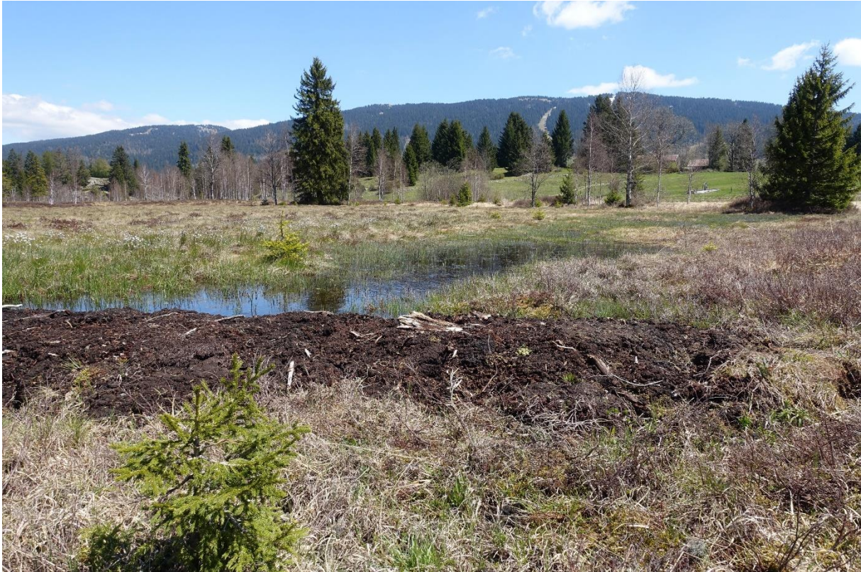
Une palissade recouverte par de la tourbe quelques semaines après les travaux, elle retient déjà l'eau dans la tourbière et la végétalisation commence juste
