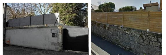
Dénaturation : les grilles ajourées et la végétation sont remplacées par des pare-vue pleins.
