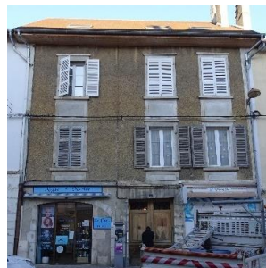
Demeure XVIIème: façade recomposée avec hiérarchisation des ouvertures des étages mais espacement horizontal irrégulier, arc surbaissé en rez de chaussée, (partiellement condamné) et linteau droit en pierre moulurée pour le porche d'entrée. Porte d'entrée avec vantaux bois à panneaux moulurés et imposte ajourée en fer forgé. Grande rue-37_p497 -c2
