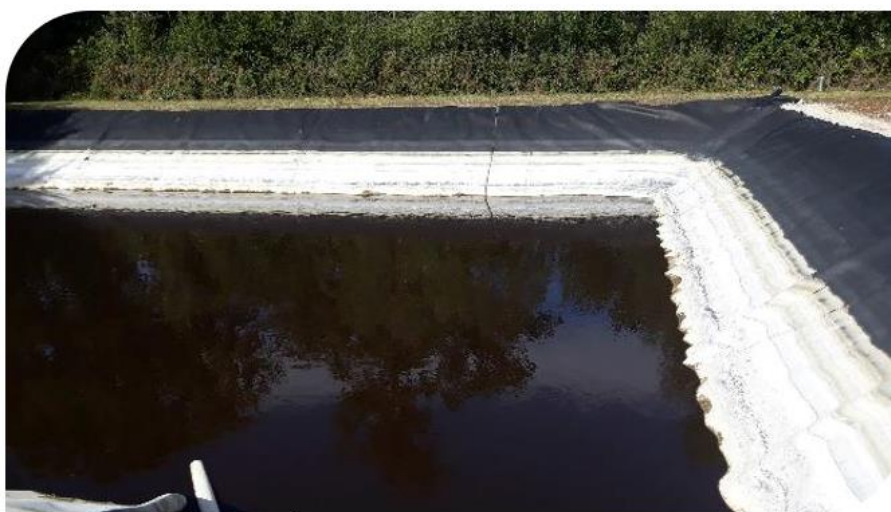
Figure 5 - Bassin de collecte des lixiviats
