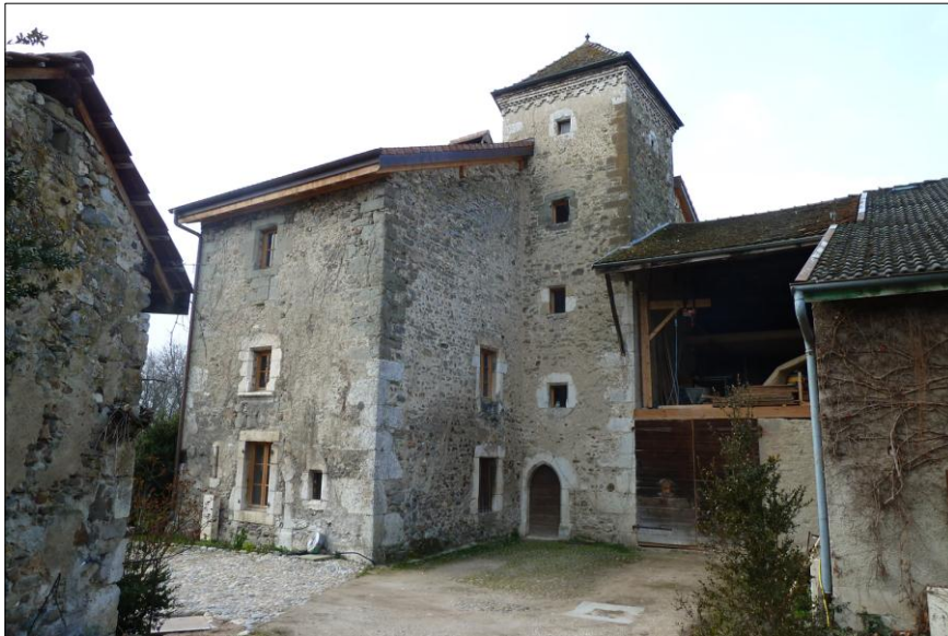
La maison haute d'Ornex, face Est avant les travaux de restauration (source : UDAP 01)
