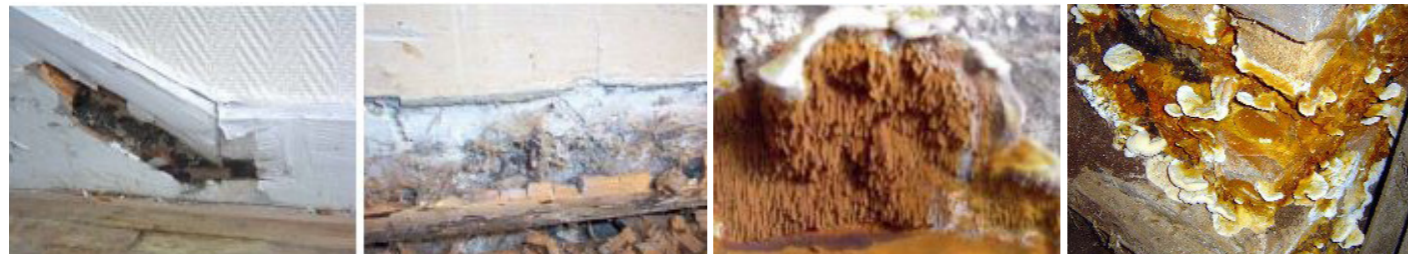
Plinthes dégradées par des mères
