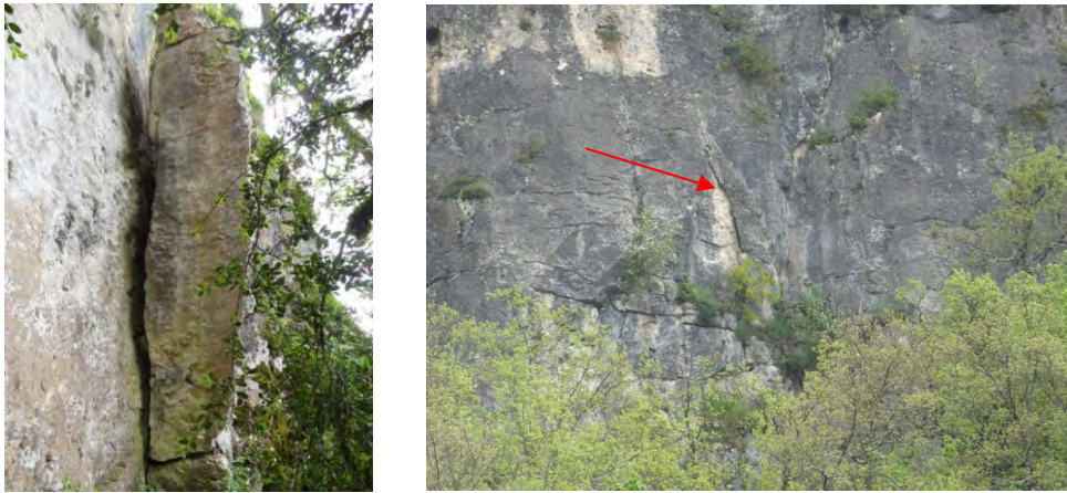
Figure 6 : Pilier de 3 à 5 m 3 à gauche, écaille de 1 à 2 m 3 à droite
