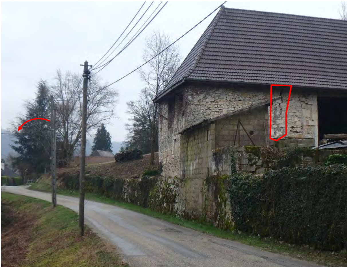
Figure 17: Exemple de désordres pouvant être dus à des terrains de mauvaise qualité
