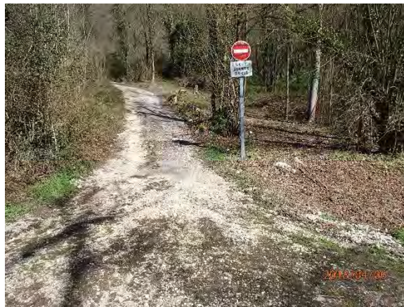
Figure 36 : Piste dans le sens de la pente, ravinée par des écoulements de surface
