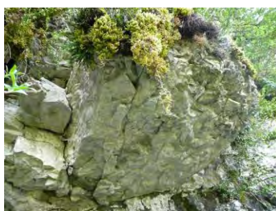
Figure 4 : exemple de masse de 0,5m^3 en surplomb
