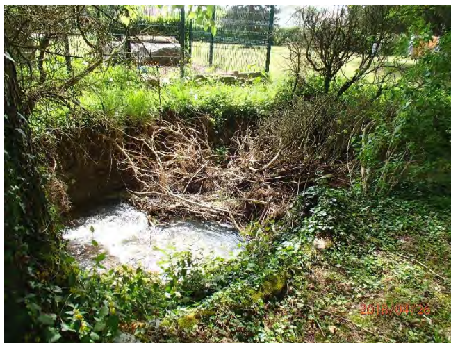
Figure 40 : Embâcle dans le lit, favorisant le débordement et l'érosion des berges
