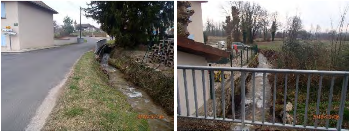
Figure 33 : Coude à 90° sous la route au carrefour RD10b/ RD10c et lit à l'aval
