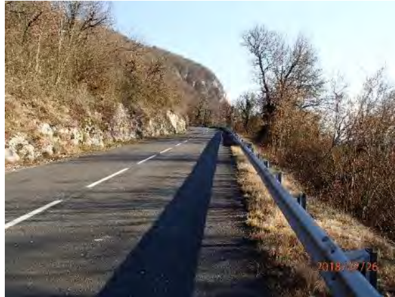
Figure 45 : Route départementale suivie par les débordements et déversement vers la droite
