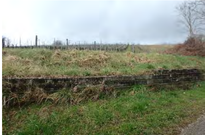
Figure 24: soutènement de fortune sur la route du cimetière
