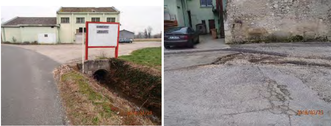
Figure 70 : Buse devant un bâtiment agricole avec des risques avérés de débordements
