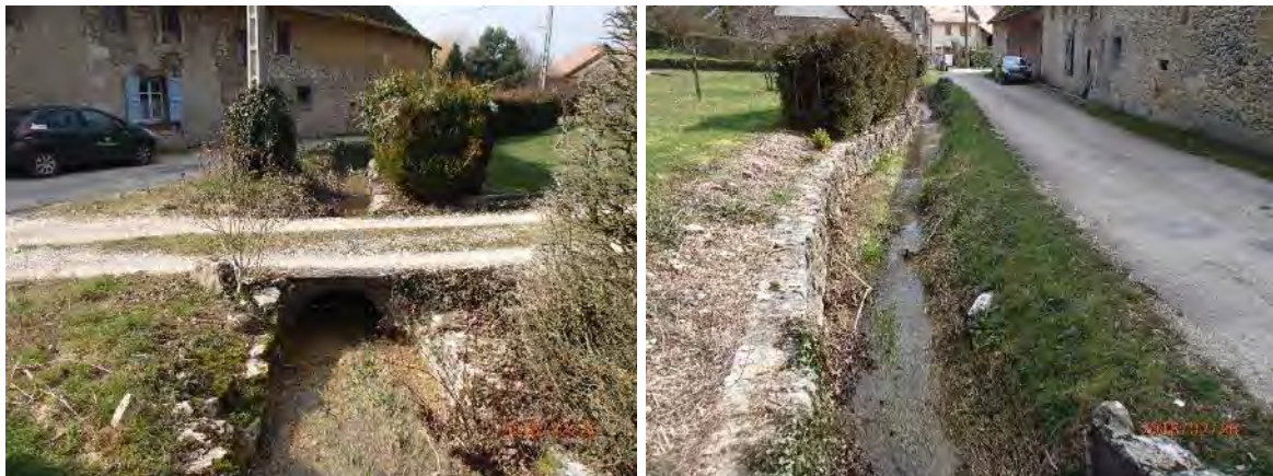
Figure 73 : Buse présentant un risque fort d'obstruction (à gauche) et route inondable le cas échéant (à droite)
