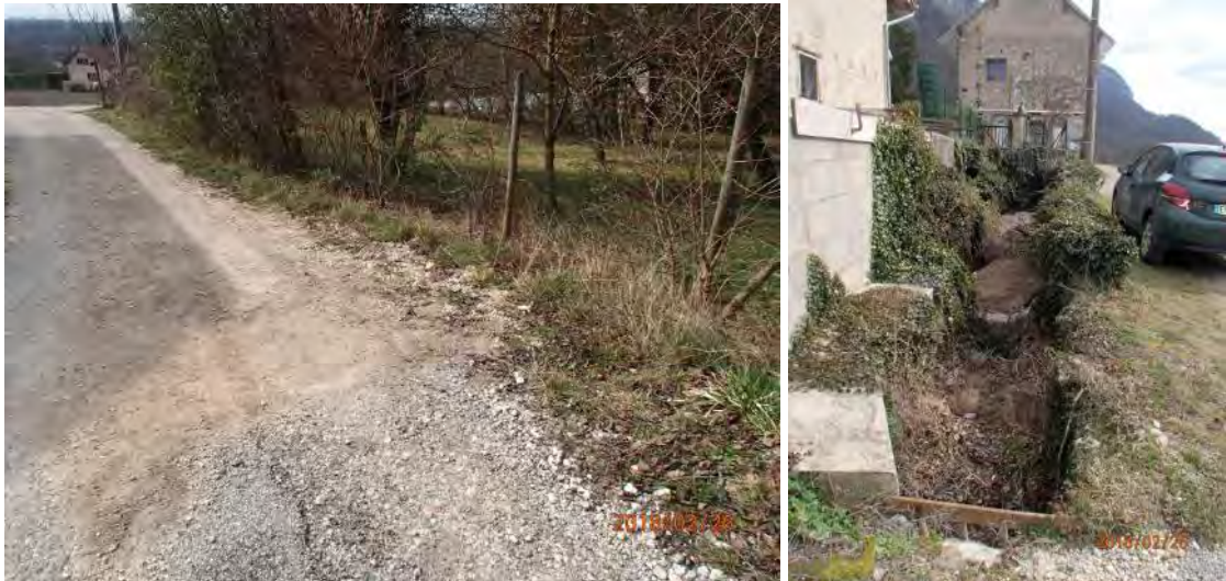
Figure 75 : Trace de ravinement sur la piste (à gauche) - bac de décantation (à droite)
