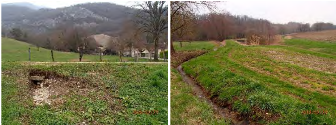
Figure 60 : Connection permettant la vidange du champ à l'amont de la route communale vers celui à l'aval (à gauche) – lit jusqu'au ruisseau de la Gorge à l'aval
