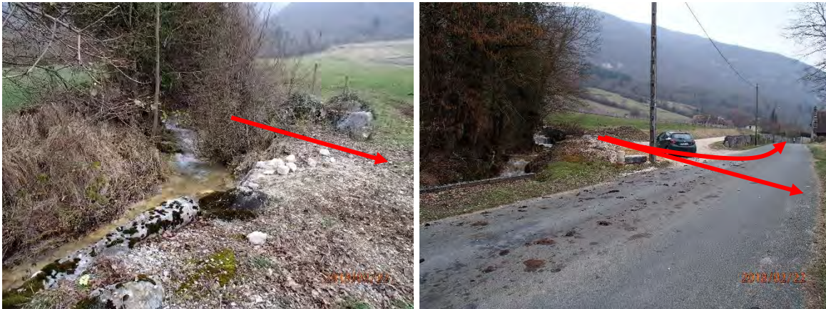
Figure 27 : Débordements possibles en amont de la traversée de la route communale entre Saint Martin et Ansolin
