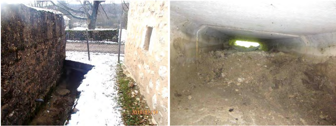
Figure 55 : Dalot engravé sous la route communale en 2015 (source de la photo de droite : commune de Lhuis)
