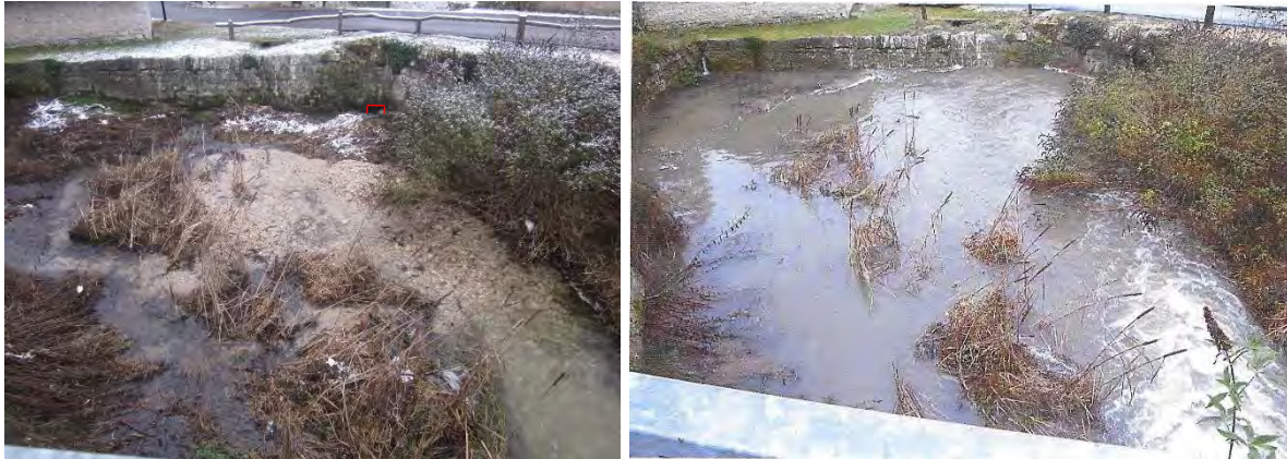
Figure 42 : Ecluse engravée et rétention d'eau due à une capacité d'évacuation devenue insuffisante (source : commune de Lhuis)
