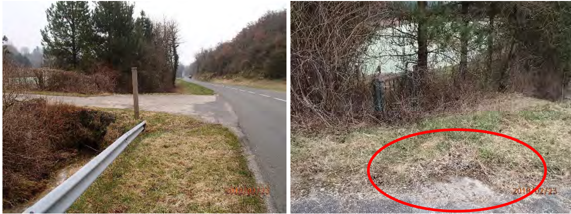
Figure 29 : Route pouvant être surversée et traces de récents dépôts
