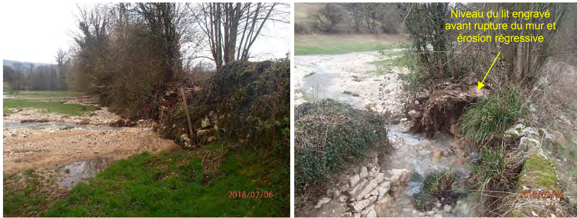
Figure 33 : Rupture du mur en rive gauche d'un ancien canal et divagations dans les champs
