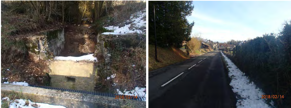
Figure 24 : Bac de décantation et RD 79 suivie par les écoulements après débordements
