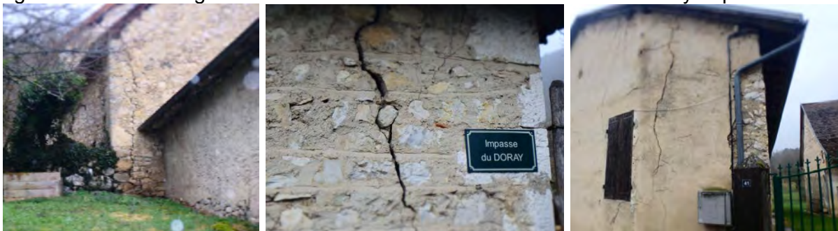
Figure 9 : de gauche à droite, maison fissurée à St Martin, maisons fissurées à Lhuis
