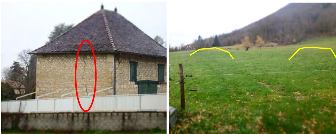
Figure 7 : maison fissurée sur Ansolin et sols bombés sur Le Poulet
