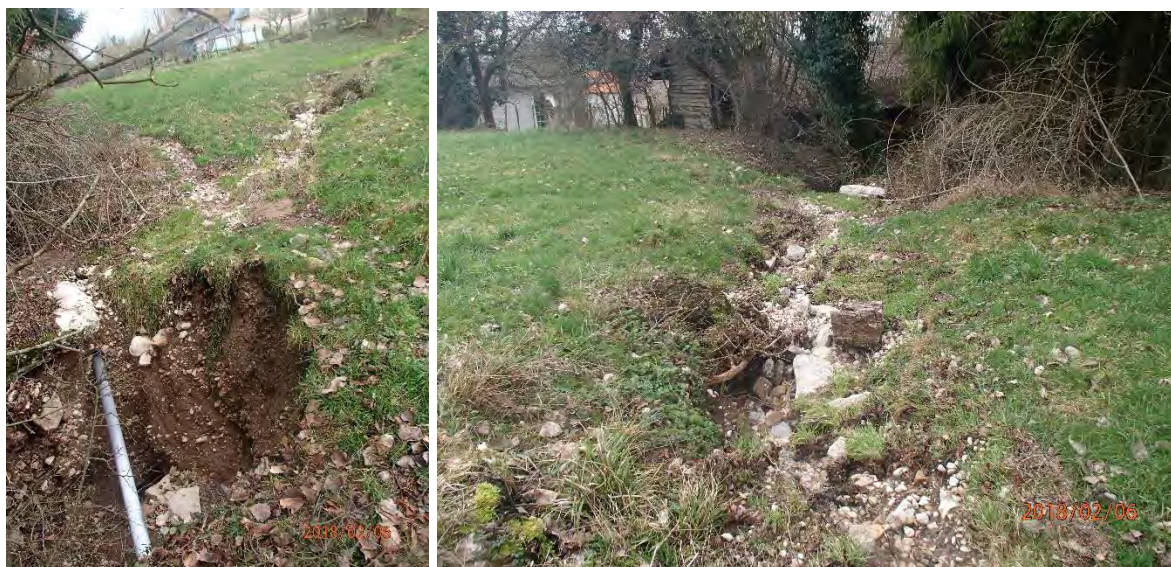
Figure 36 : Erosion du Pisserot à l'amont immédiat de la confluence avec le ruisseau du Moulin
