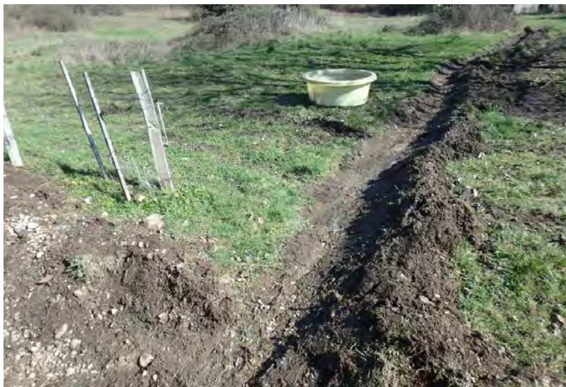
Figure 6 : tranchée en amont de Fléviu pour lutter contre des coulées de janvier 2018
