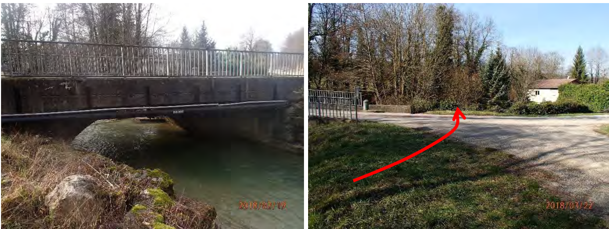
Figure 15 : Débordements au droit du pont de la RD79 en cas d'obstruction par embâcles
