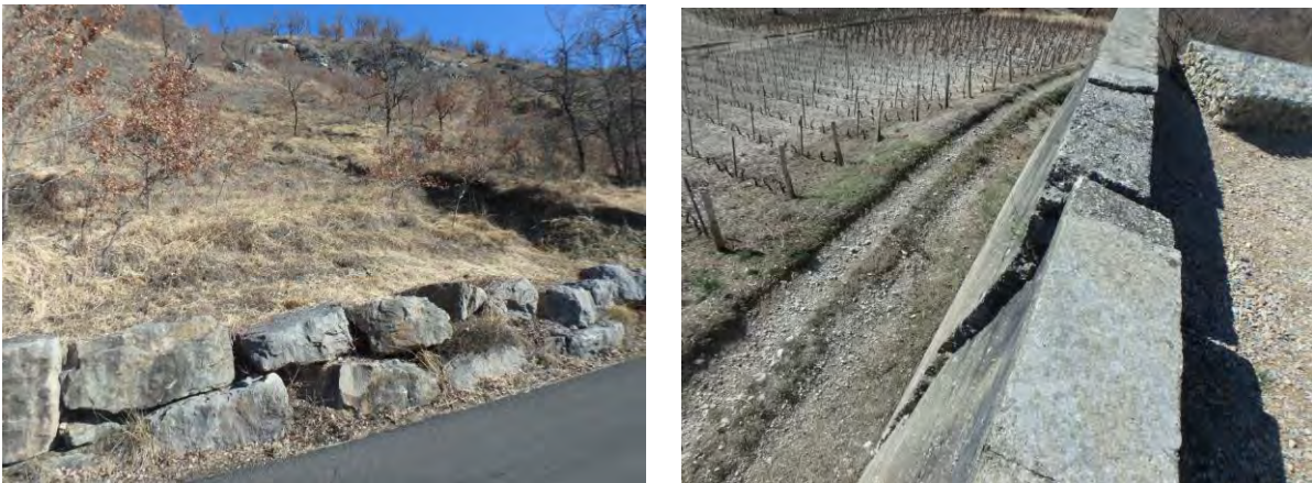
Figure 7 : à gauche, arrachement d'un glissement ancien, à droite mur de soutènement fissuré
