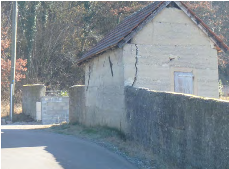
Figure 4 : Désordres sur un cabanon
