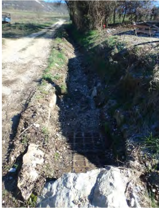
Figure 20 : fossé collectant des ruissellements des coteaux avec grille obstruable
