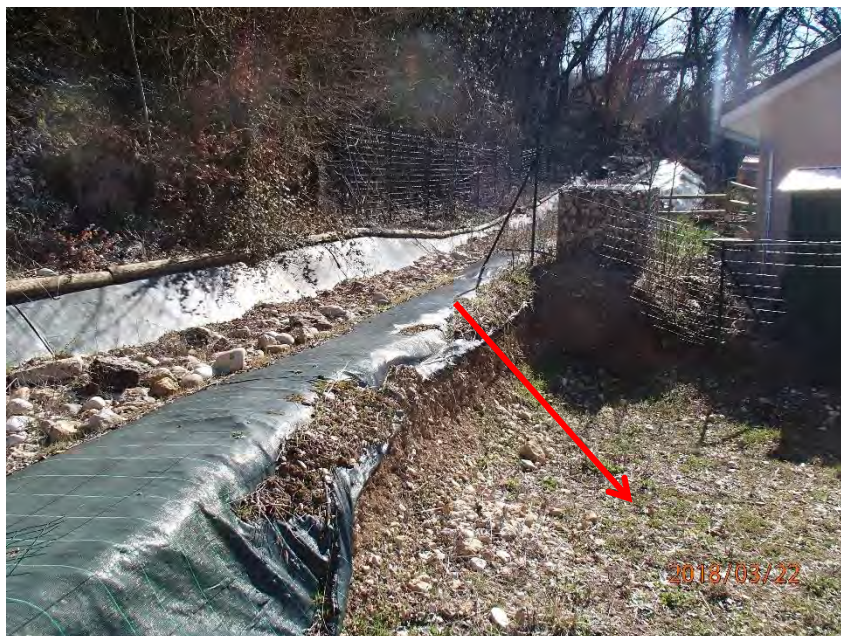
Figure 35 : Point de débordement possible au niveau de la déviation Nord
