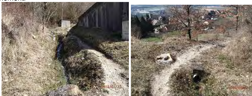
Figure 19 : Axe de ruissellement issu d'un réservoir et buse sous dimensionnée en cas de ravinement
