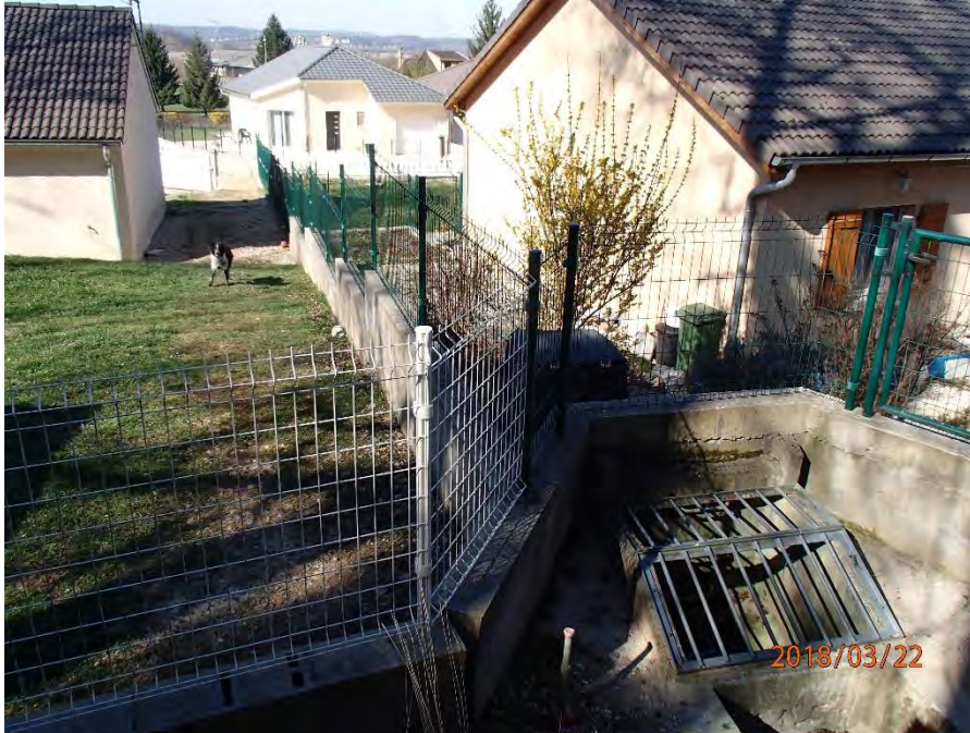
Figure 36 : Grille avaloir sous dimensionnée
