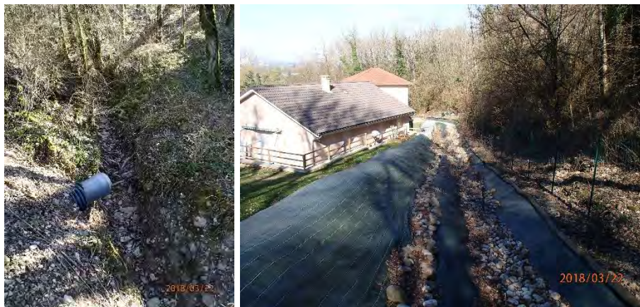
Figure 33 : Déviation inefficace vers le Nord de la ravine Nord
