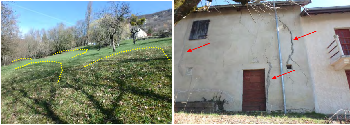
Figure 7 : Divers désordres constatés sur ce secteur
