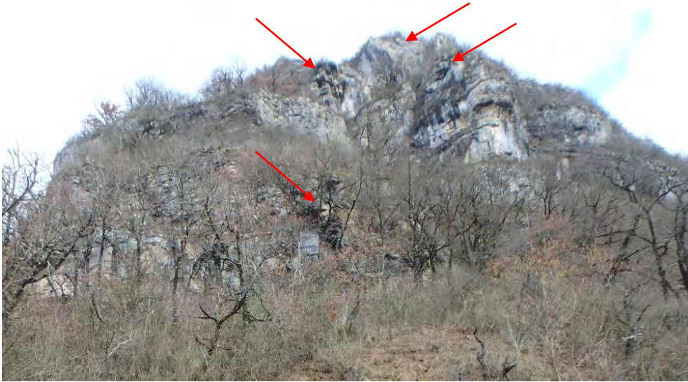
Figure 7 : masses instables au Nord de la Dent
