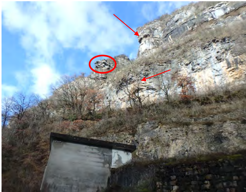
Figure 8 : masses instables au Sud de la Dent
