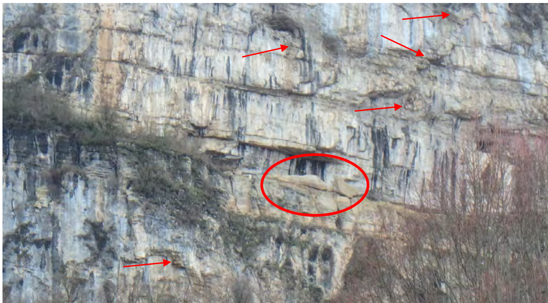
Figure 5 : blocs éboulés posés sur la vire et petites masses instables
