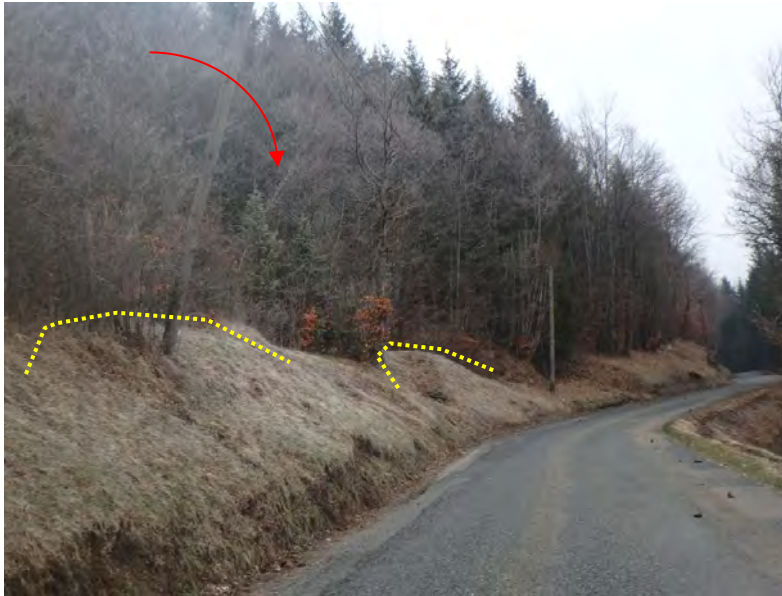
Figure 15 : Talus routier bombé et poteau incliné au droit de la RD99
