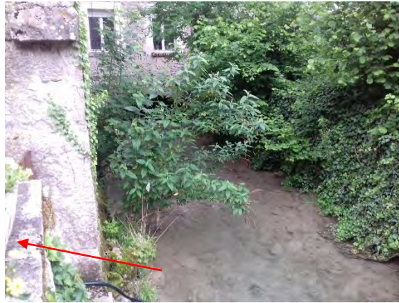
Figure 27 : Point bas sur la berge rive gauche
