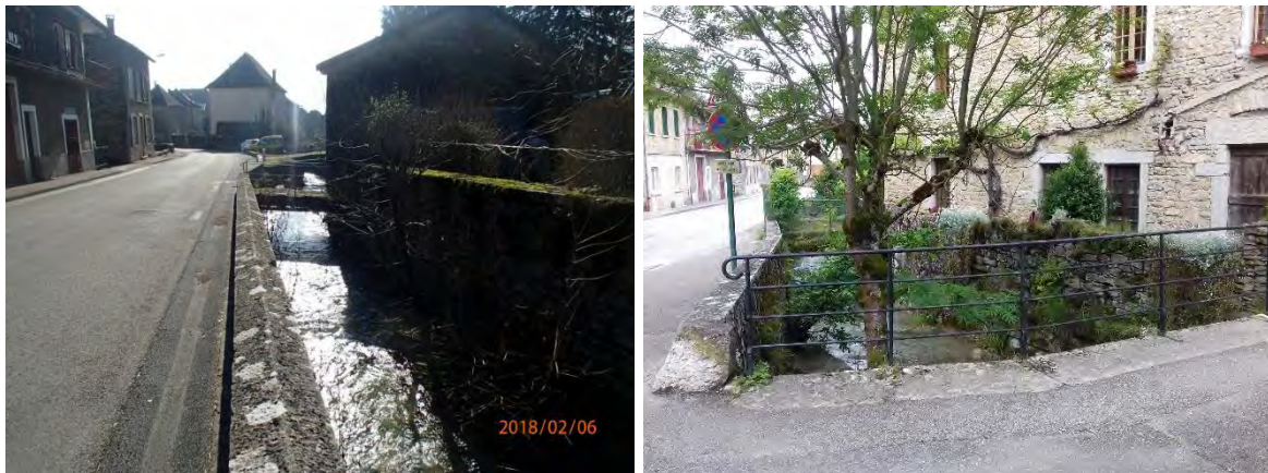
Figure 25 : Succession de passerelle dans la traversée urbaine et maison en rive droite exposée
