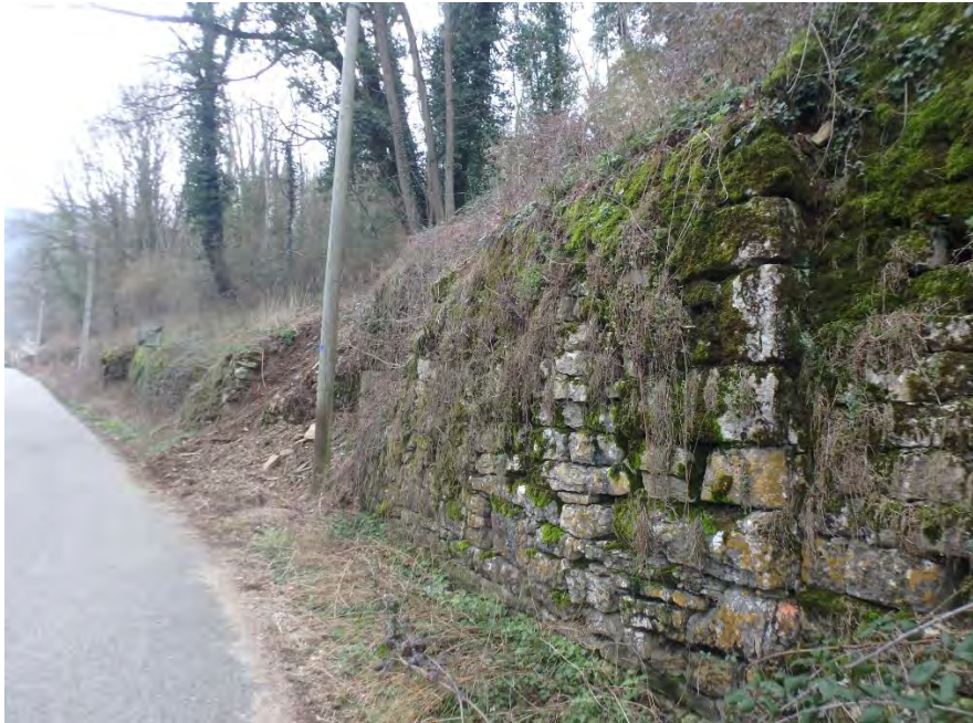
Figure 14 : murs bombés au niveau de l'école
