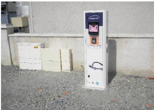
Borne recharge électrique
