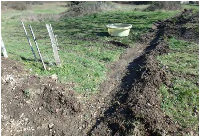
Figure 9 : tranchée en amont de Flévieu pour lutter contre des coulées de janvier 2018
