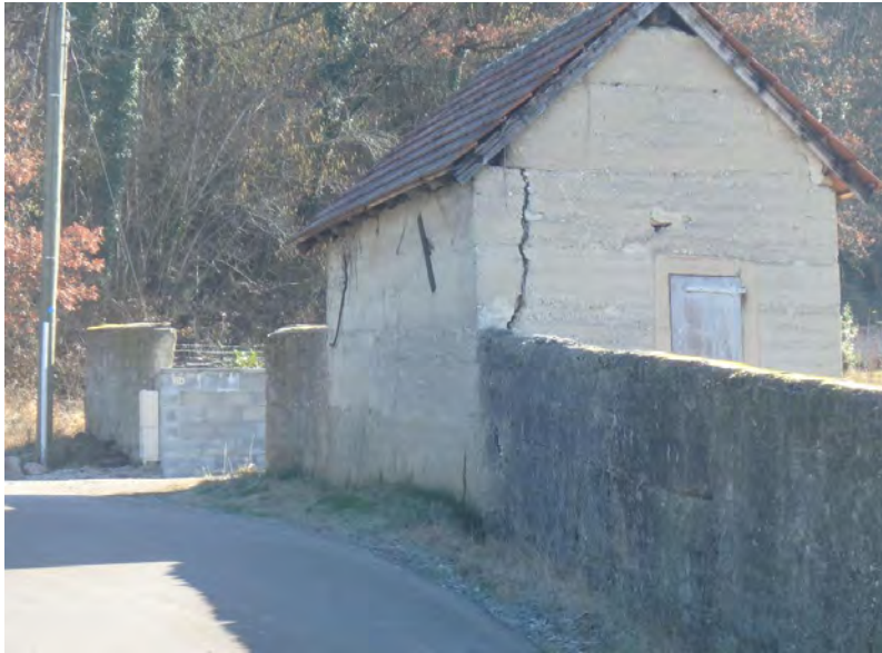
Figure 7 : Désordres sur un cabanon
